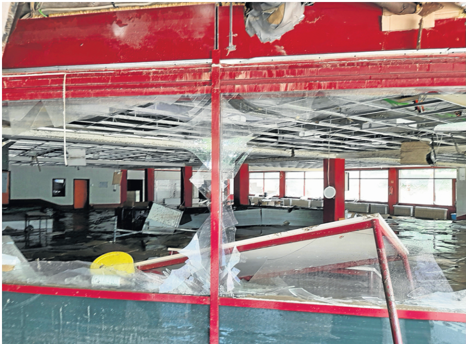
So sah der Ganztagsbereich des Rhein-Gymnasiums in Sinzig am Morgen nach der Flut aus. Das Wasser hatte die Fenster eingedrückt.
